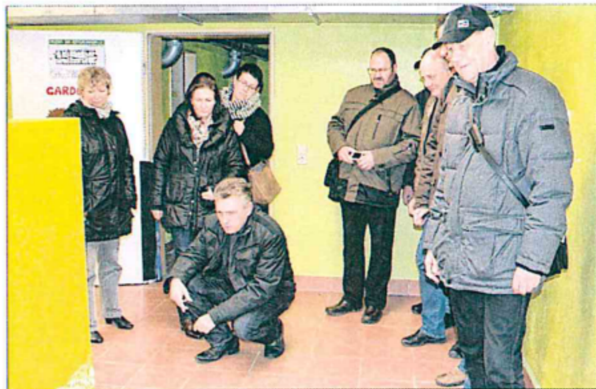
Die Mitglieder des Ortschaftsrates Ebendorf besichtigten die Kindertagesstätte „Gänseblümchen“, dabei vor allem den Keller, der seit Jahren wegen Pilzsporen verschlossen ist. Foto: Karl-Heinz Klappoth
